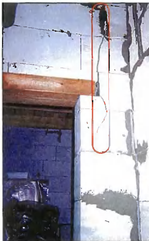
Трещины в блочной кладке стен
