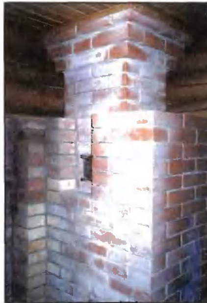
Случай интенсивного использования банной печи. Горячие газы, прогревая кладку, не пощадил изумительную внешность кирпича (не буду называть производителя). Все дополнительные добавки в сырье при производстве кирпича придают ему шикарный вид, повышают механическую прочность, но термостойкость при этом уменьшается. Пример тому — эти высолы, которые появились от нагрева!
