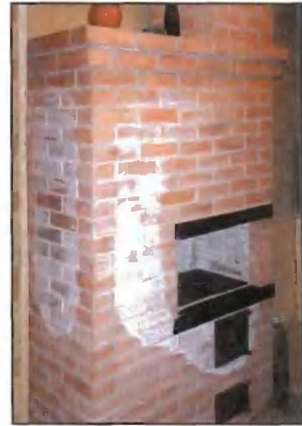
Печь, построенная бригадой из ближнего зарубежья. Видно, как устроены дымообороты и где самые горячие места ее стенок. И как только не пытался домовладелец избавиться от белых пятен... А если сказать, что задвижка размерами 125x250 мм «закрывала» дымоход сечением 250x250 мм, то понятно, почему в комнате становилось холодно через 3–4 часа после нормальной протопки печи
