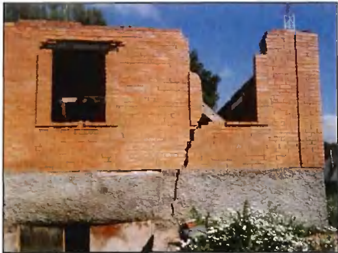
Разрушение коттеджа при промораживании пучинистого основания под фундаментной плитой
